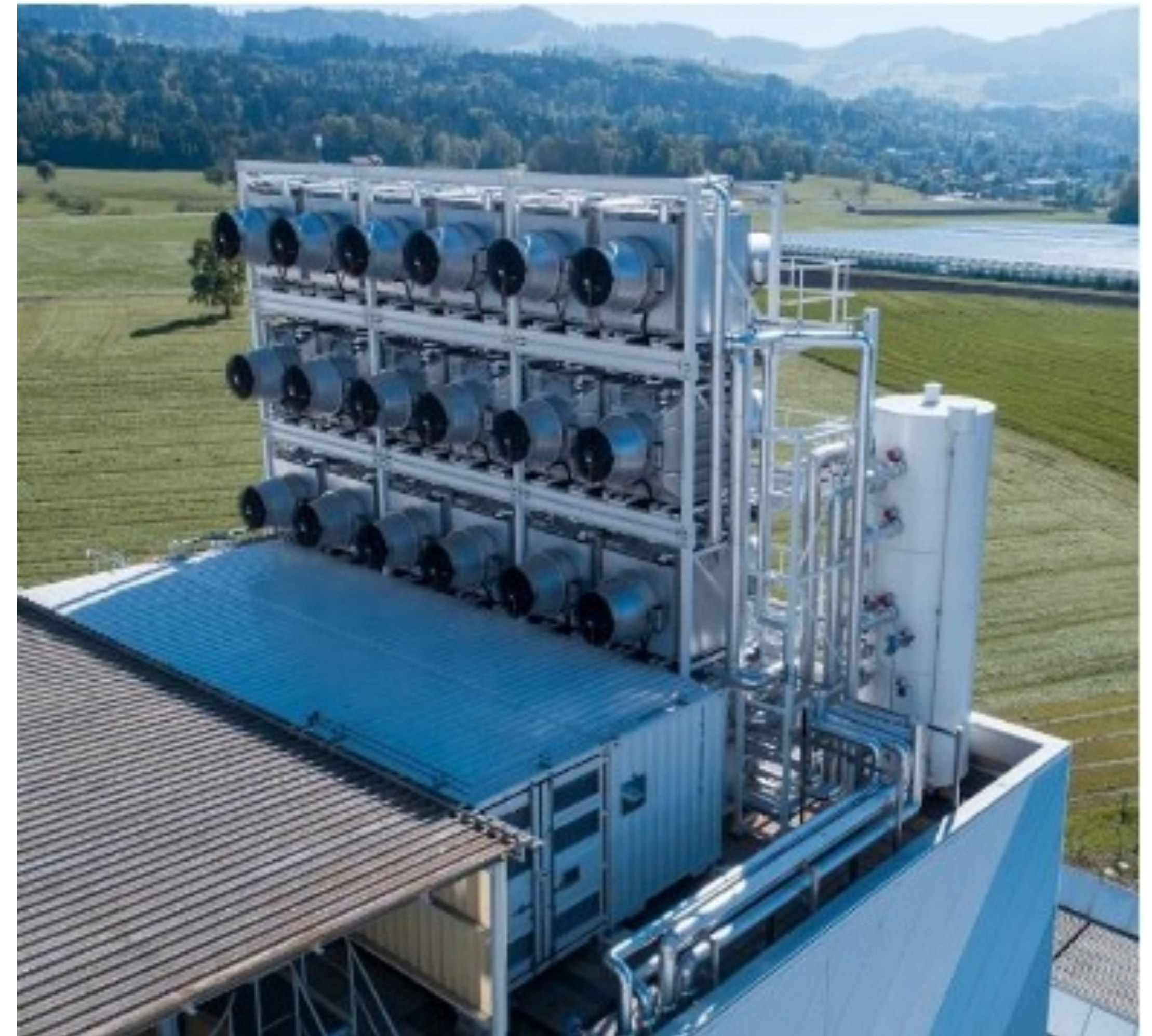
Weltweit erste kommerzielle DAC-Anlage (Climeworks, Hinwil); DAC-18, 900 t CO 2 /a; scinexx, 6. Juni 2017, http://bit.ly/2s7uvvH
